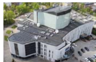
Zbudowana z paneli fotowoltaicznych elektrownia słoneczna na dachu KCK w Kielcach
